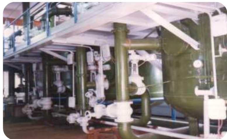
تصفیه خانه آب کارخانه کاغذ پارس
