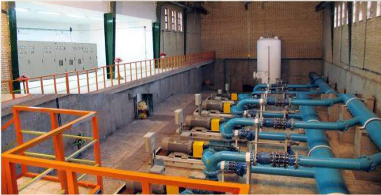
ایستگاه پمپاژ آب شهر بروجرد
